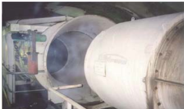
Электростанция в Манароуги, Новая Зеландия. Плавный пуск для вентиляторов, насосов и лебедок.
