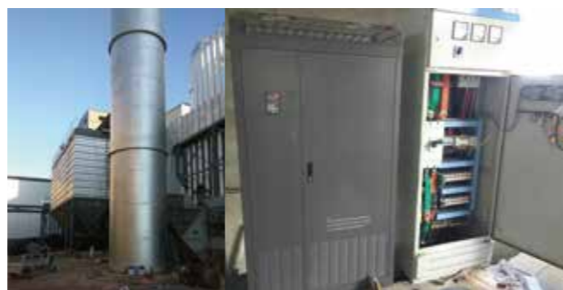
CV3100-630KW变频器在除尘器设备上的应用
