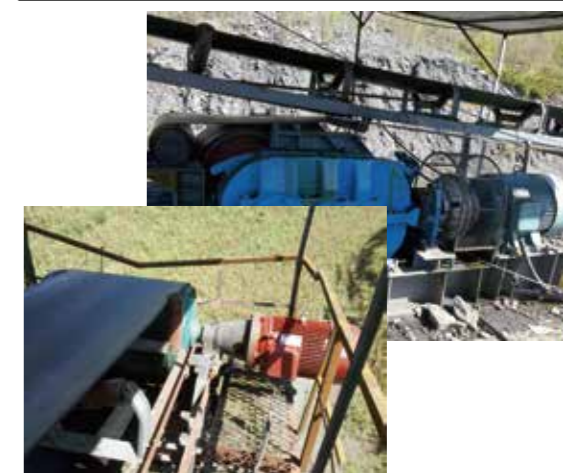
易驱变频器六盘水某矿的现场
