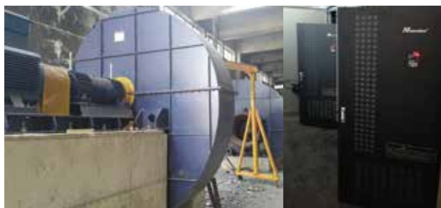
在供暖锅炉离心风机上的应用
