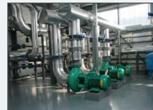
ОВК и водоснабжение
